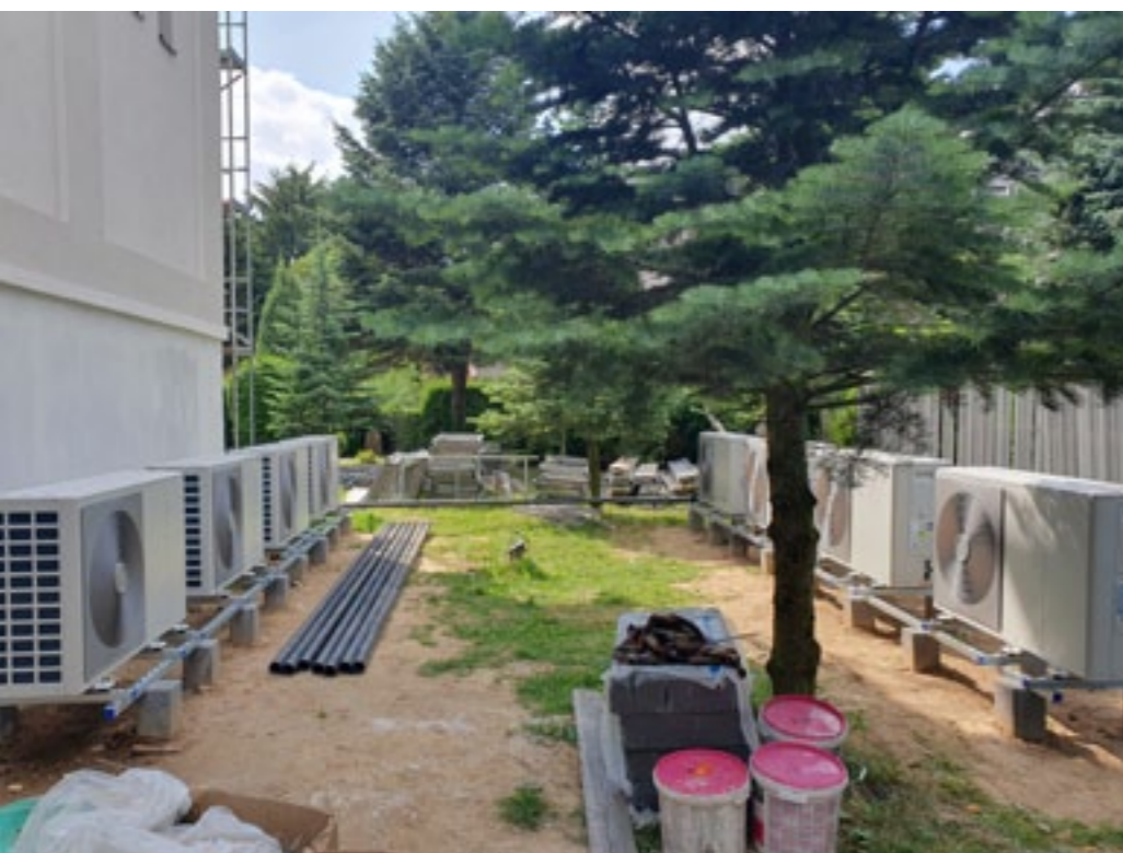
Instalacja pomp ciepła Modena w Sanktuarium w Kałkowie-Godowie
