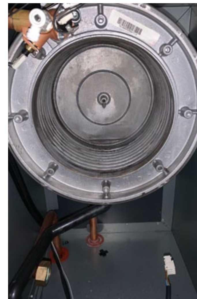
Komora spalania gazowego kotła kondensacyjnego (strona ogniowa) po wyczyszczeniu
