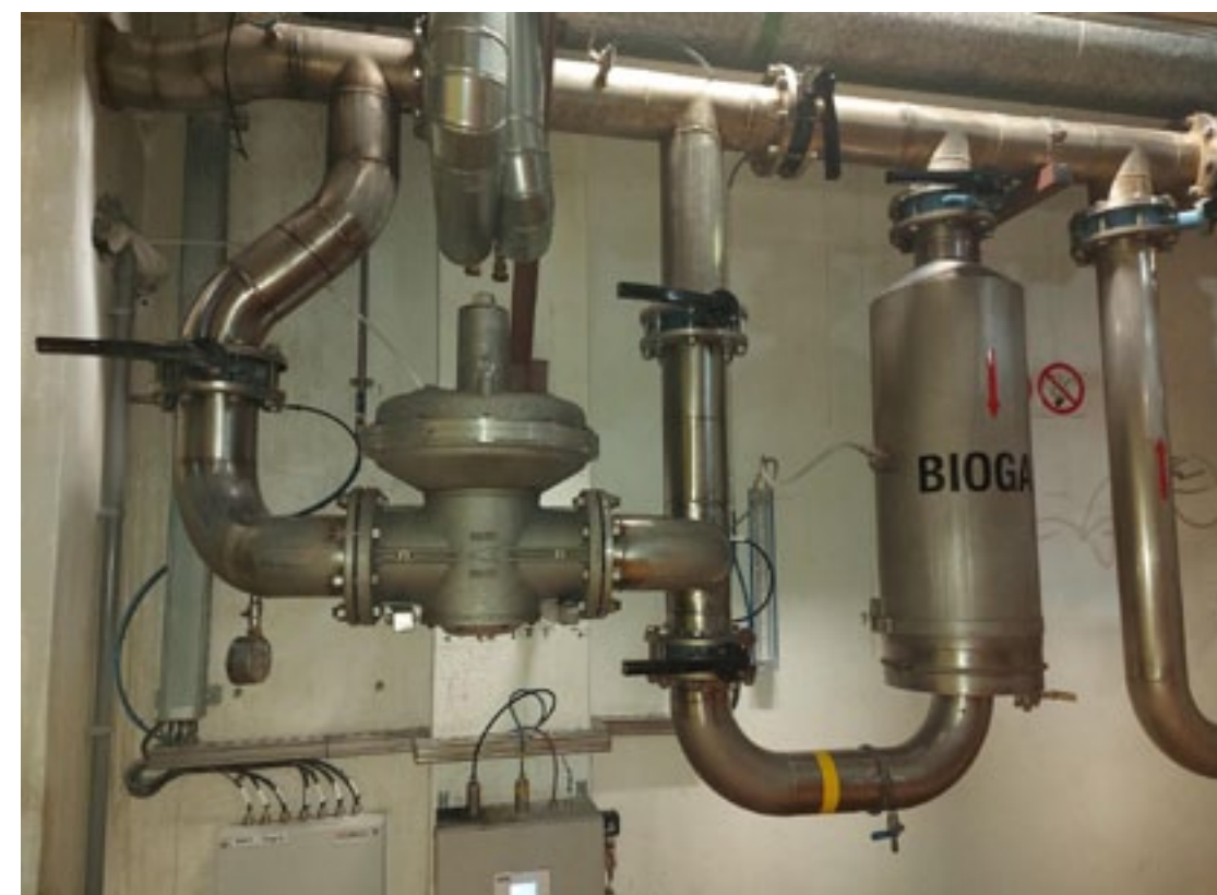
Reduktor gazu ST1B DN150 w instalacji gazu
