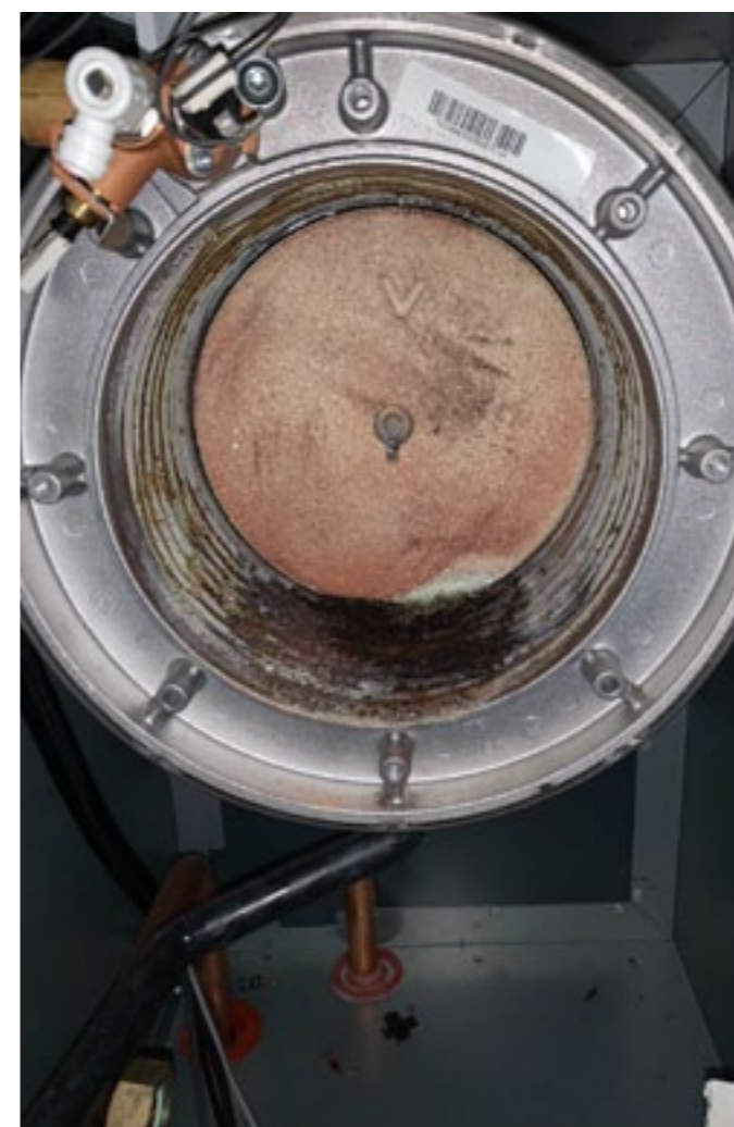
Komora spalania gazowego kotła kondensacyjnego (strona ogniowa) przed konserwacją
