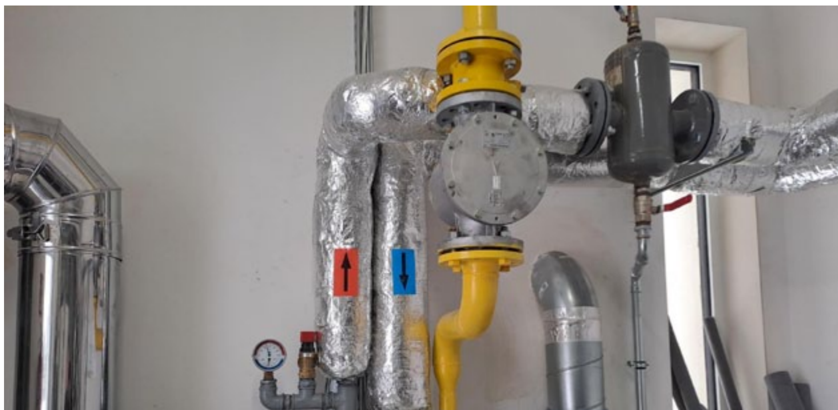
Filtr gazu serii 70600 w instalacji zasilania gazem
