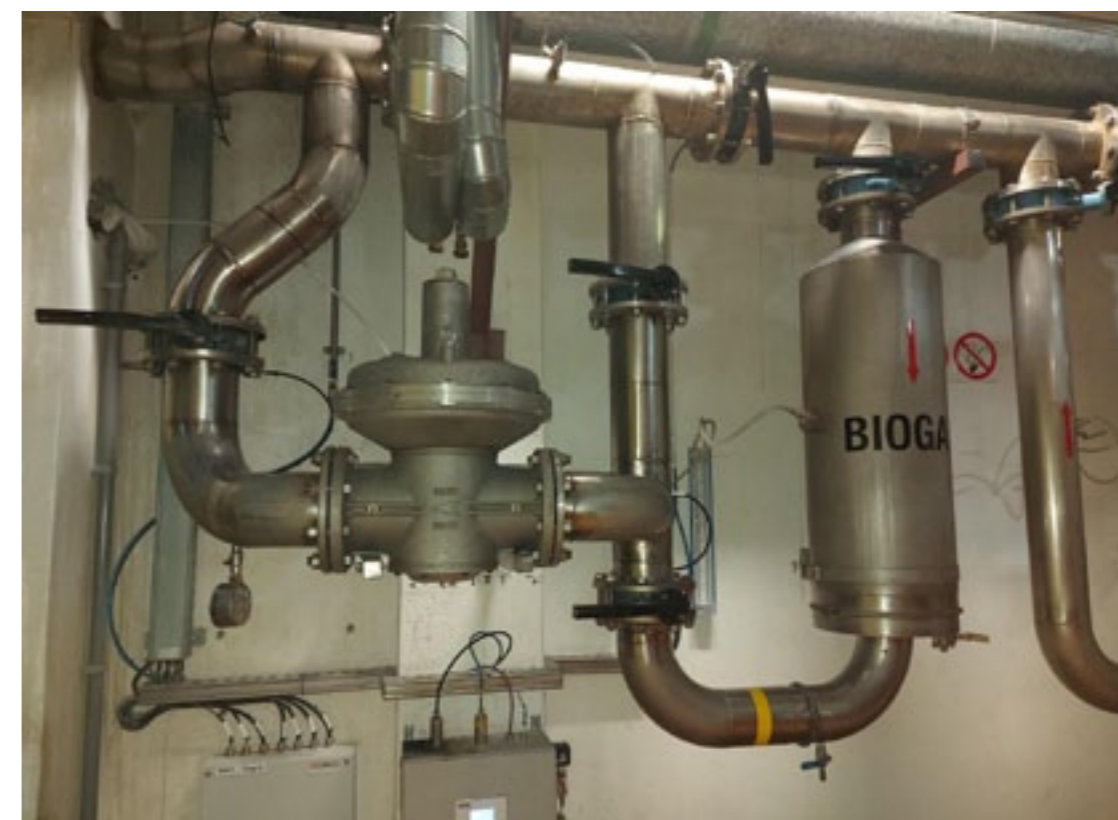
Reduktor gazu ST1B DN150 w instalacji gazowej
