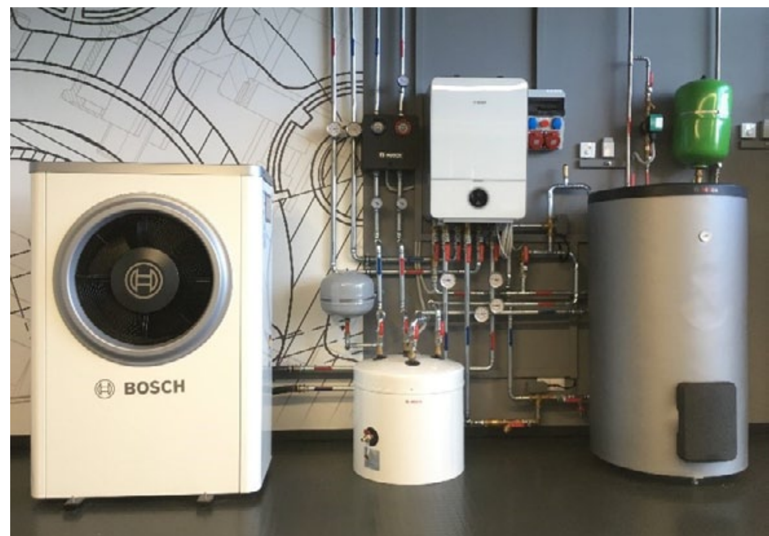
Pracująca instalacja pompy ciepła CS7000i AW na sali szkoleniowej Junkers-Bosch w Warszawie
