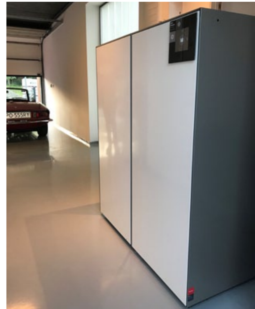
Jednostka wewnętrzna SYSTEMU M umieszczona w garażu
