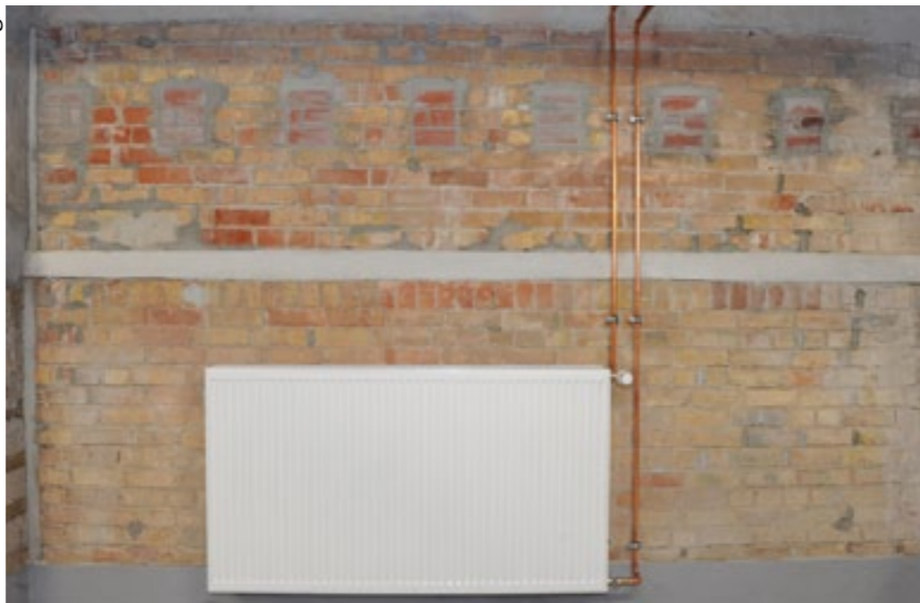
Do rurociągów i podłączenia grzejników w piwnicach zastosowano system połączeń zaprasowywanych z miedzi Profipress
