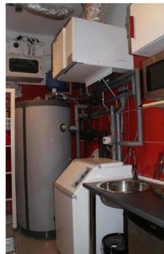
Instalacja pompy ciepła NIBE F1150 wraz z 300- -litrowym zasobnikiem c.w.u. NIBE VPA 300/200 i modułem wentylacyjnym NIBE FLM 30
