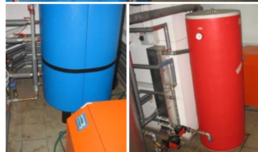
Pomieszczenie z kotłami olejowymi, pompą ciepła Hibernatus W14W3x2E i sprzęgłem ciepła
