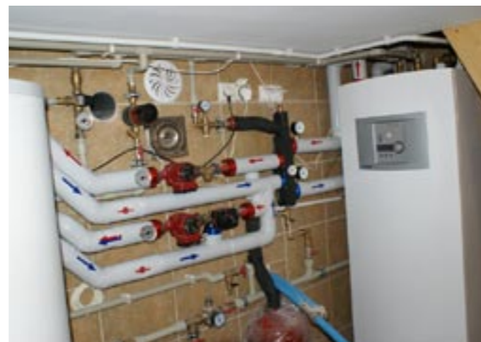
Pompa ciepła TM 75-1 marki Junkers + zasobnik solarny
