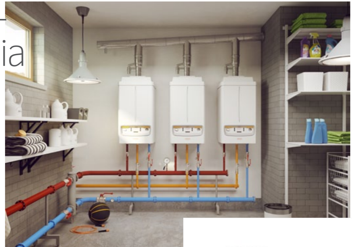
Kaskada kotłów Victrix Pro 55
