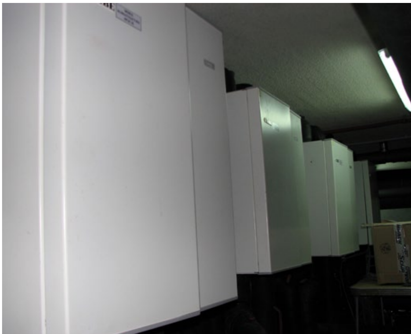
Kaskada modułów chłodzenia aktywnego NIBE HPAC współpracujących z klimakonwektorami, zasilana pompami ciepła NIBE o łącznej mocy 240 kW, zainstalowanych w Hotelu Żubrówka w Białowieży
