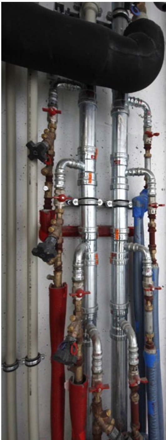
Fragment instalacji ciepła technologicznego w systemie Prestabo
