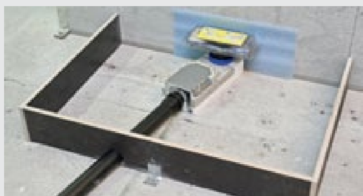
Ten układ syfonowy został umocowany możliwie blisko ściany, a następnie połączony z rurą odpływową
