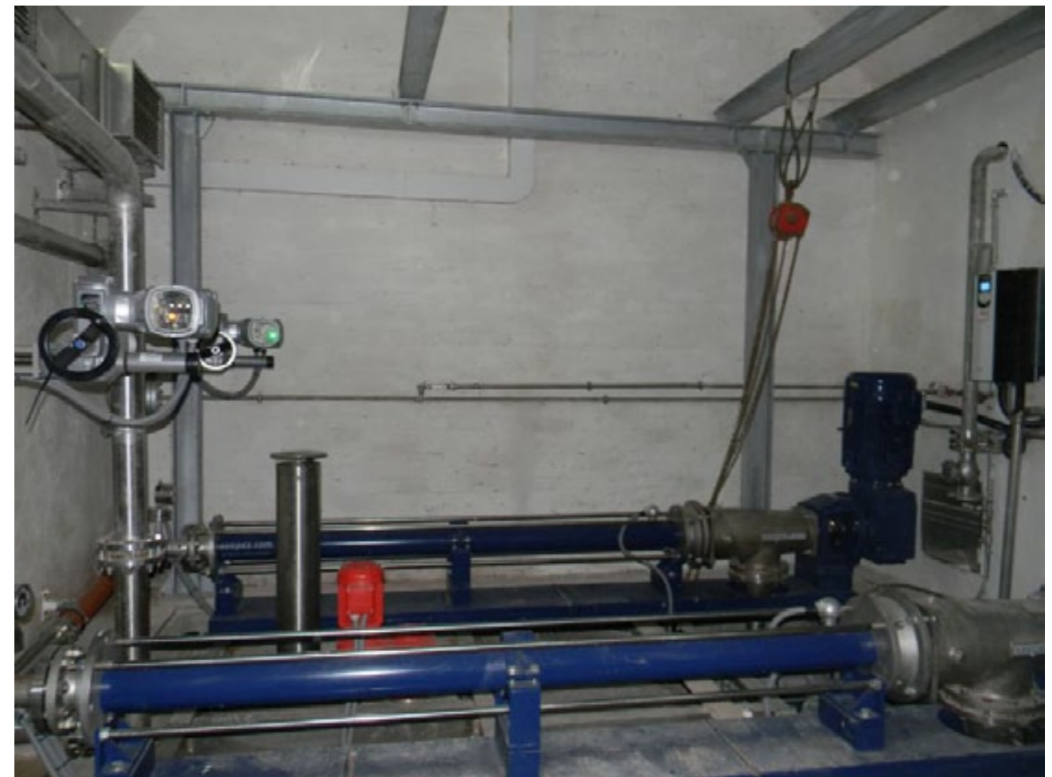
Pompownia ścieków w kopalni „Guido” wyposażona w pompy SEEPEX
