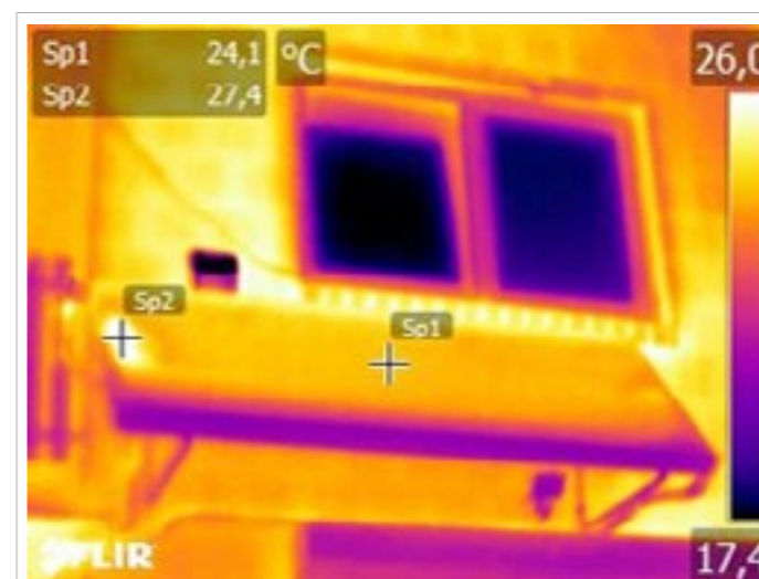
Na termogramie widać anomalię związaną z przegrzewem części kolektora w miejscu odprowadzenia ciepła.
