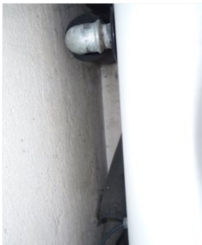
2 Brak izolacji „na niedostępnym kolanie”
