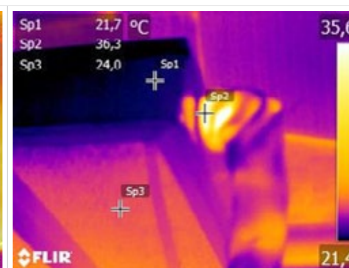
W miejscu doprowadzenia czynnika roboczego widać duże braki w izolacji cieplnej.
