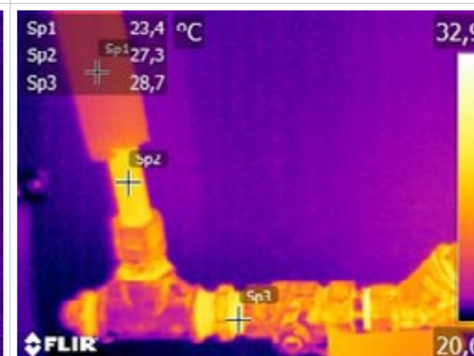
„Oszczędne układanie izolacji” Sp2 i brak izolacji na armaturze.
