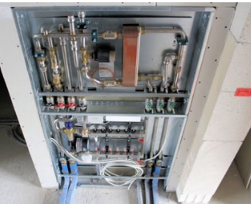
Zainstalowane w obiekcie Living East mieszkaniowe węzły ciepłne składają się z obiegowego modułu grzewczego (u dołu) oraz modułu świeżej wody ciepłej (u góry)
