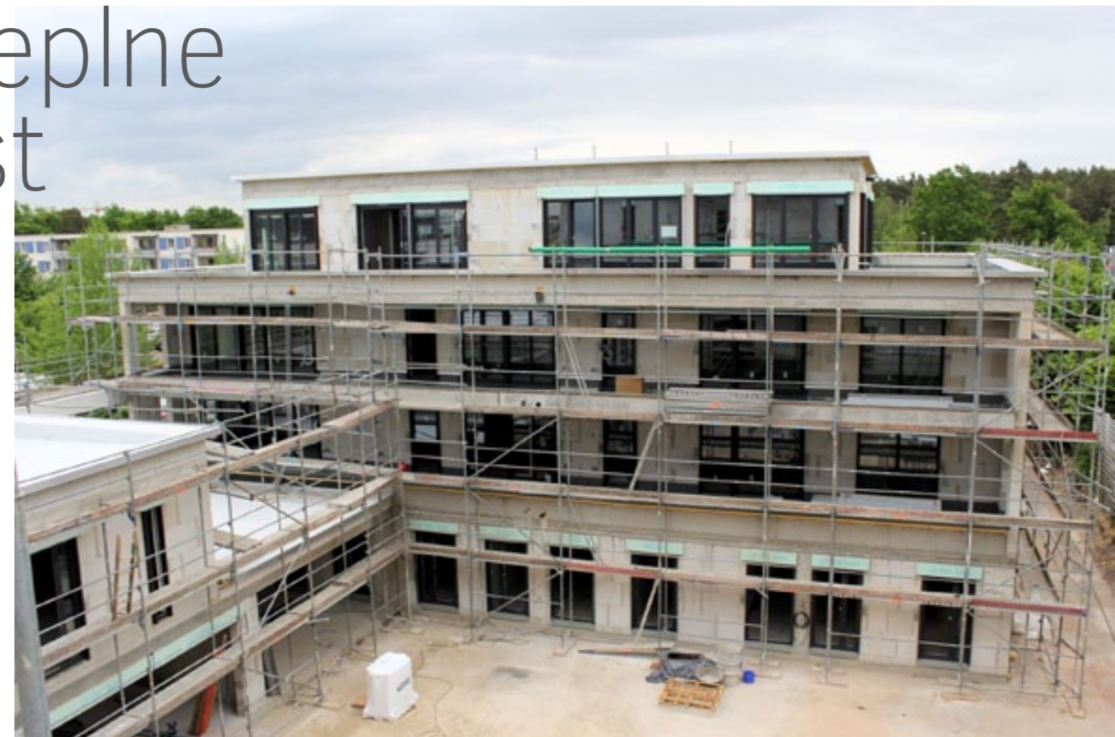
Mieszkaniowe węzły ciepłne zabudowane w 28 mieszkaniach nowo budowanego obiektu Living East w Erlangen zapewniają odpowiednie do potrzeb dostarczanie ciepła oraz podgrzewania wody użytkowej
