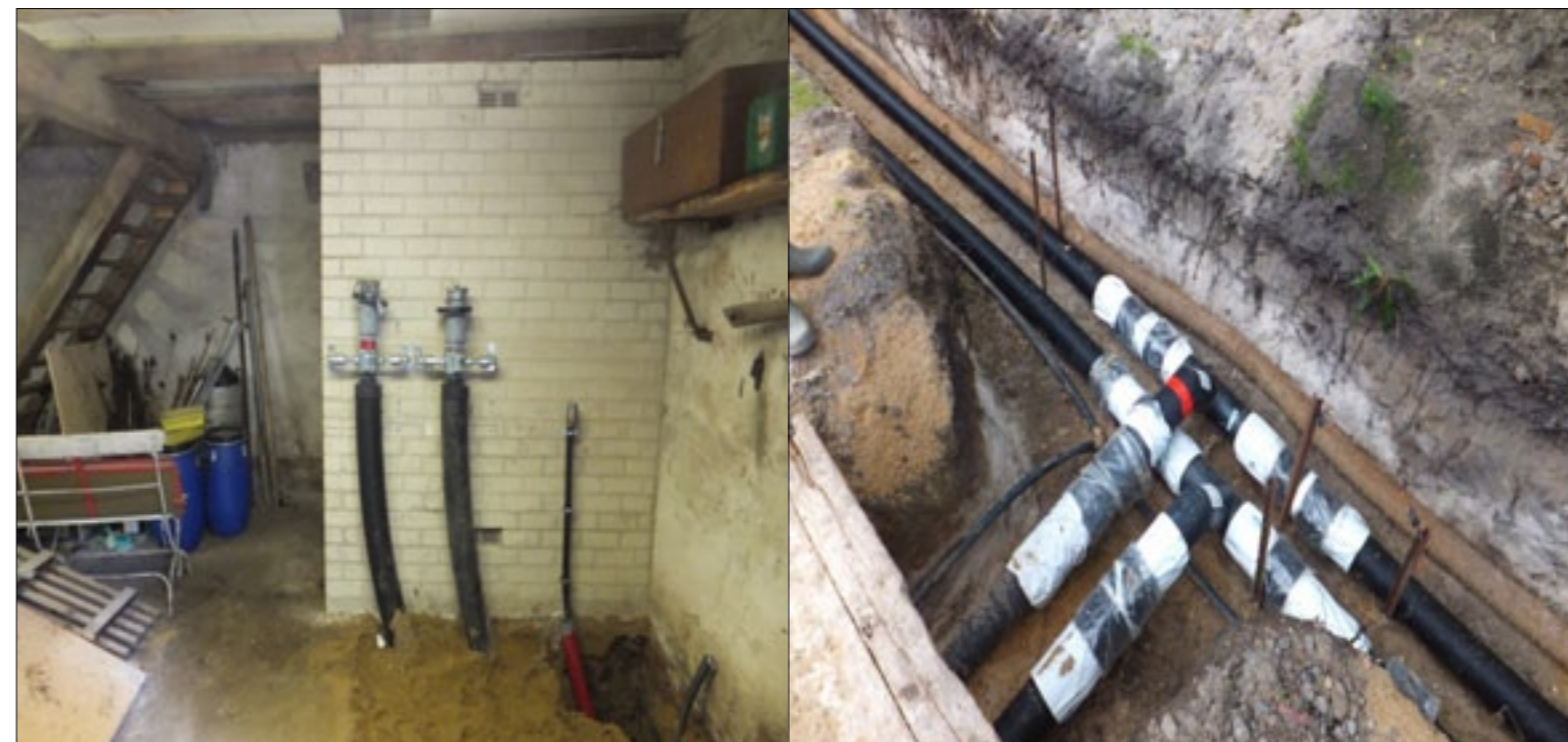
Ciepło z biogazowni w Otternhagen jest przesyłane systemem preizolowanych rur Flexalen do gospodarstwa hodowlanego i okolicznych domów
