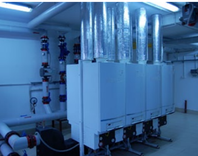
Kotłownia na osiedlu EBJOT w Ursusie – kaskada kotłów GB162
