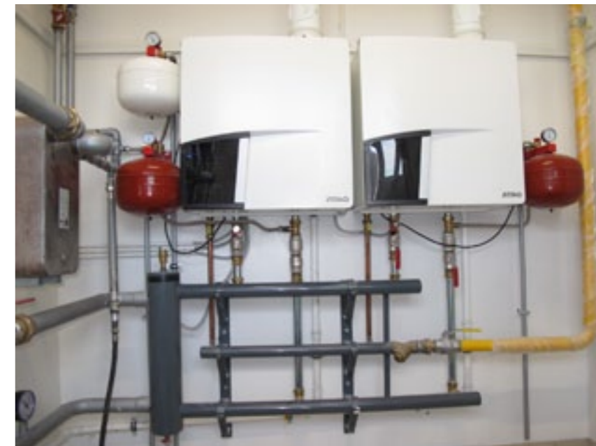
Kaskada ATAG w kotłowni sklepu Biedronka w Koninie (faza budowy)
