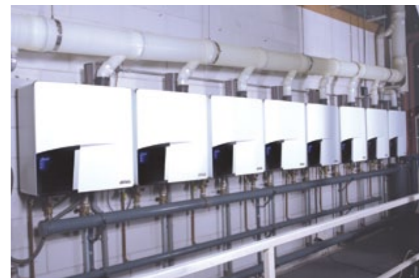
Kaskada kotły Q
