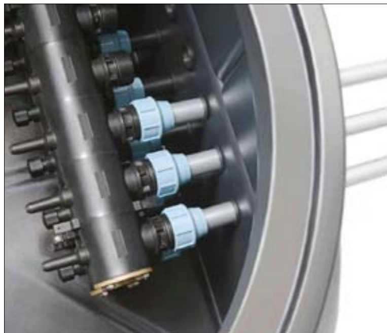
6 Podłączenie rur dobiegowych do studni rozdzielaczowej z przepływomierzami
