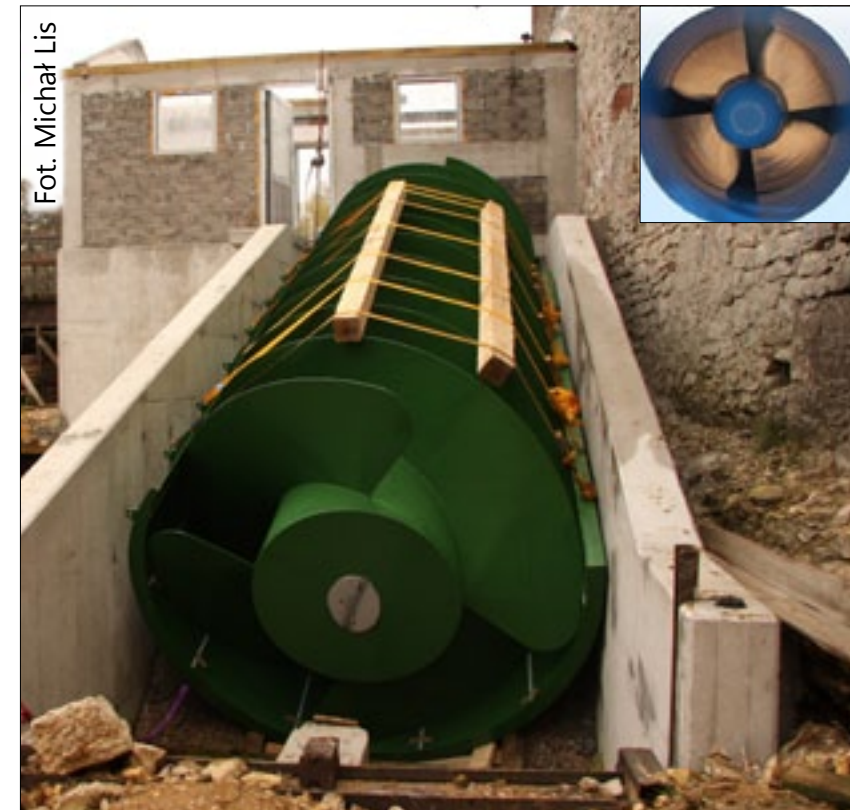
Przebieg prac instalacyjnych – śruba Archimedesowa po osadzeniu w korycie żelbetowym oraz turbina Kaplana tuż przed umieszczeniem w klatce turbinowej
