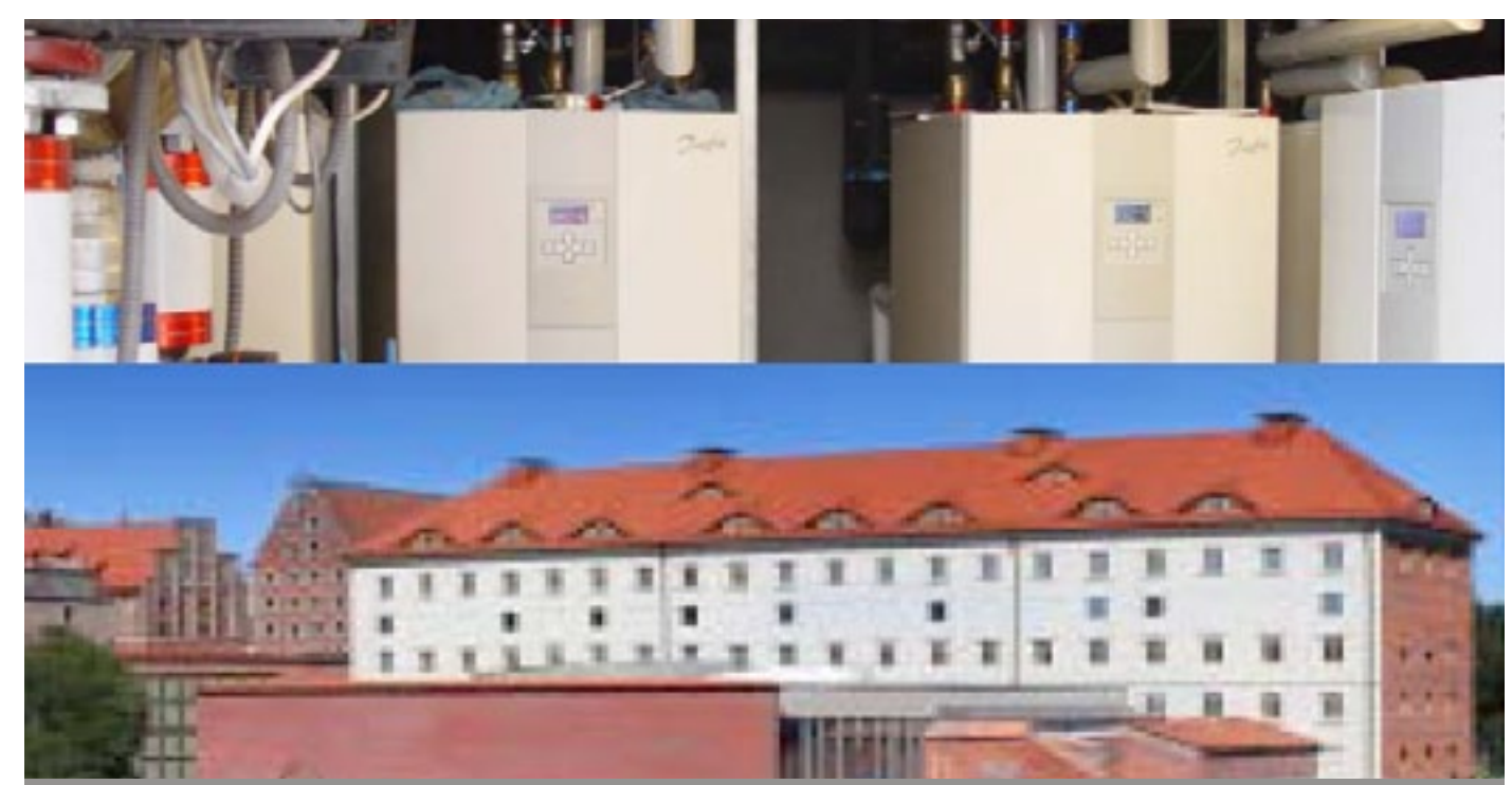
Hotel Bulwar **** w Toruniu, pięć pomp DHP-R 42 kW
