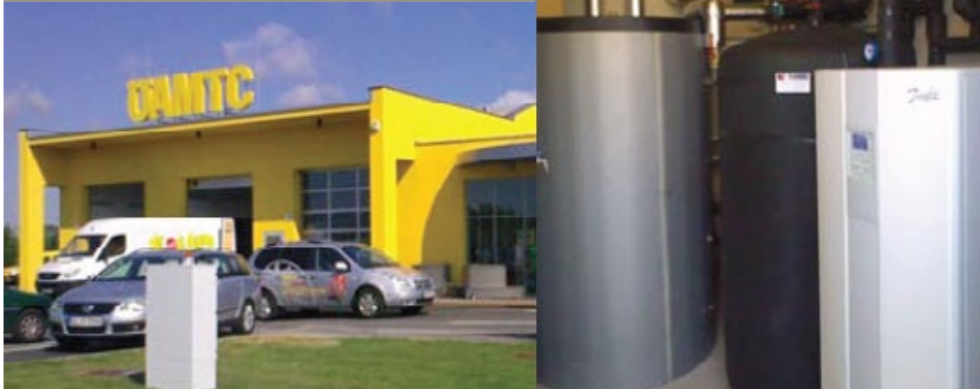
Stacja techniczna austriackiego automobil klubu OAMTC w Bruck w Austrii, pompa DHP-R 35 kW
