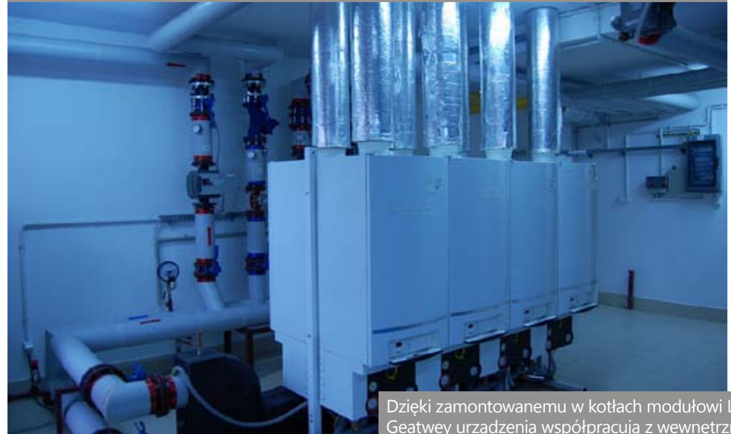
Kotłownia na osiedlu EBJOT w Ursusie – kaskada kotłów GB162
