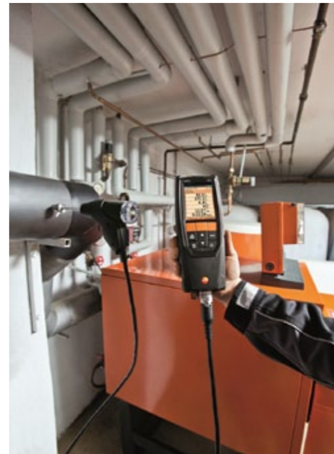
Pomiar spalin analizatorem testo 320
