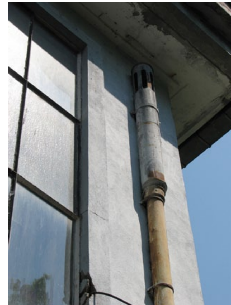
3 Stara wywiewka żeliwna usytuowana nieprawidłowo w pobliżu otworów okiennych
