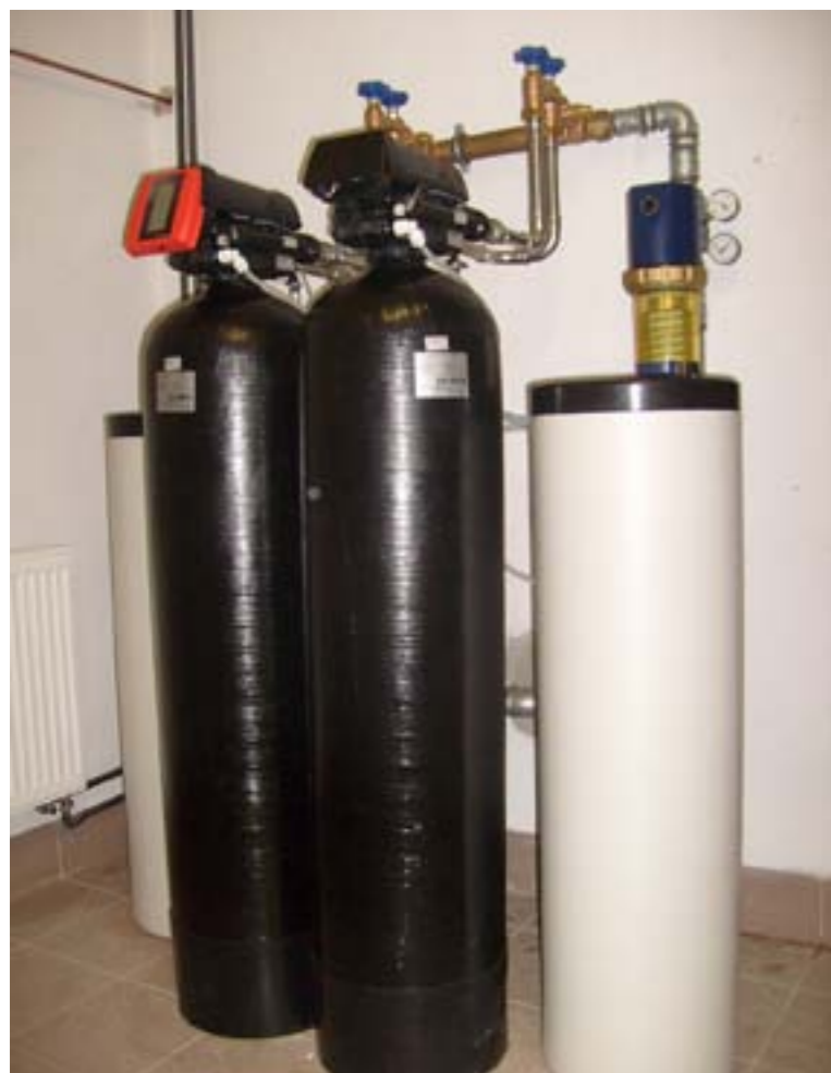
Zmiękczacz SaoCal Duplex w instalacji
