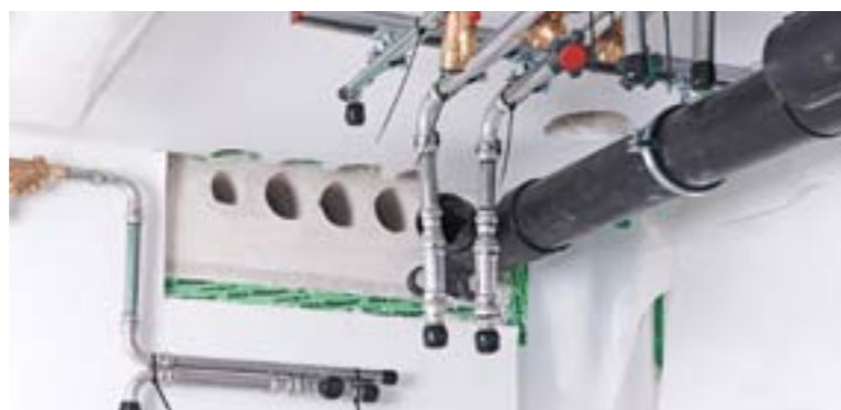
Montaż w warunkach Antarktyki wymagał maksymalnej dokładności. Otwory do instalacji wody pitnej wykonanej w systemie Sanpress Inox – stal nierdzewna 1.4521
