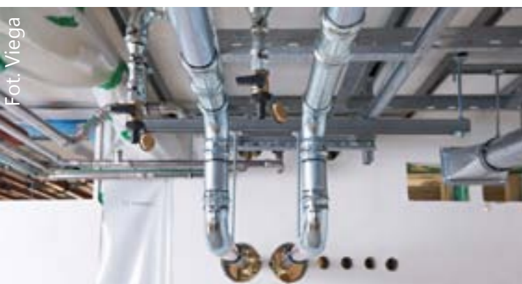
Do instalacji grzewczej zastosowano system Prestabo firmy Viega, wykonany z elektrolitycznie galwanizowanej stali
