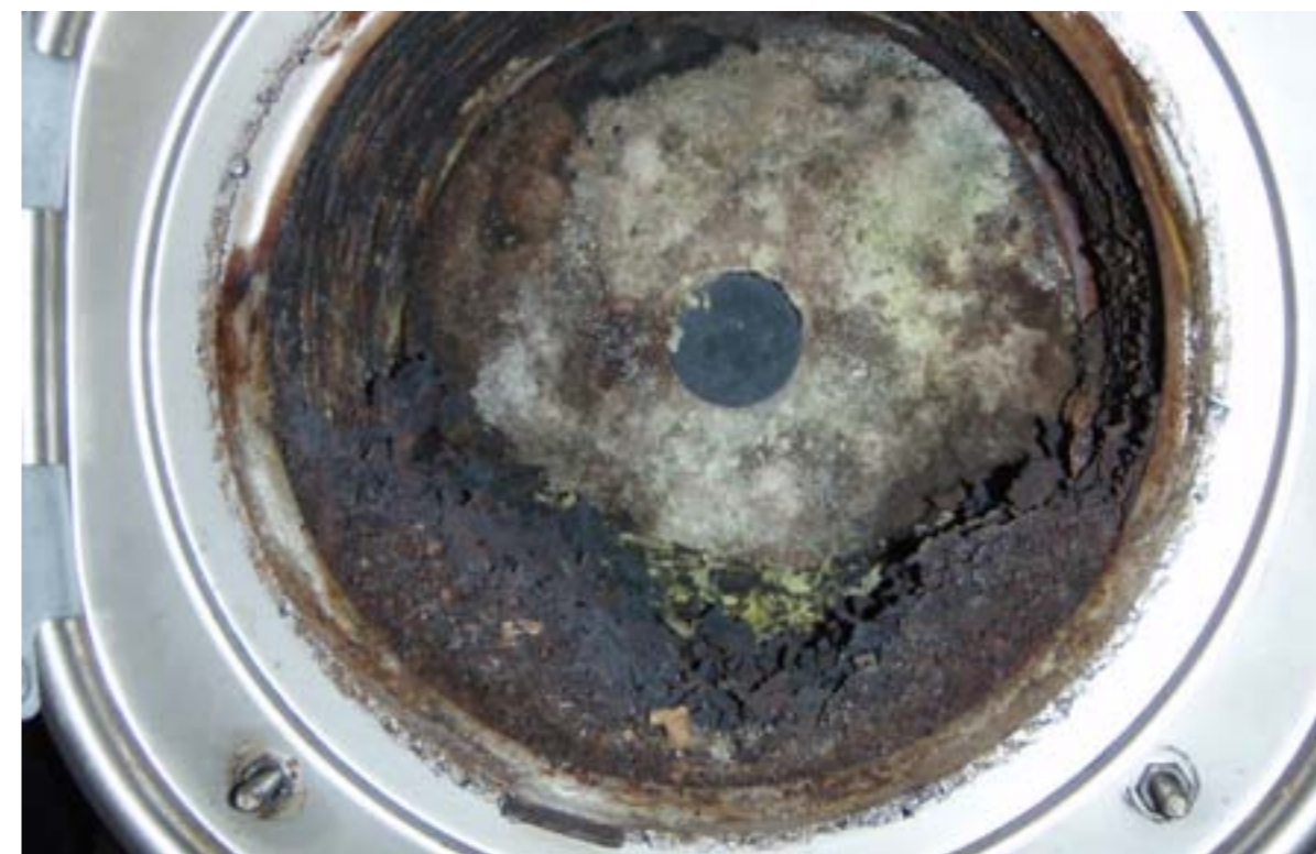
Zanieczyszczony wymiennik kotła kondensacyjnego. Kocioł ten pracował w bardzo niekorzystnych warunkach, zasysał bowiem do spalania powietrze z dymem z kotła stałopalnego
