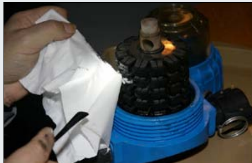
7 Czyszczenie filtra magnetycznego z nagromadzonych osadów
