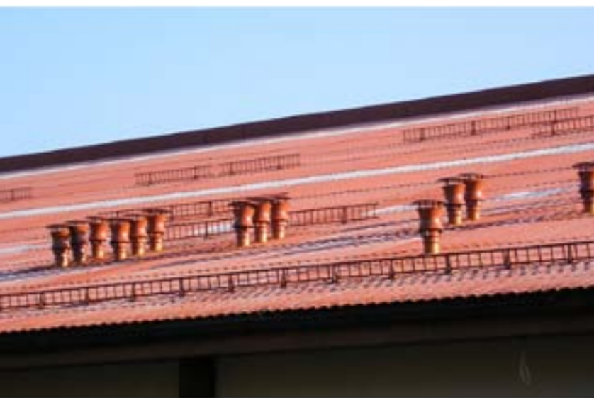
Wywietrzniki Bora na skośnym dachu
