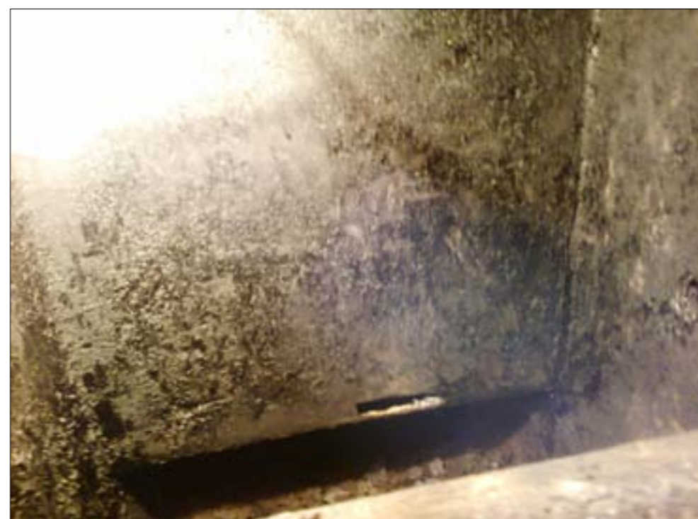
4 „Korozja niskotemperaturowa” wymiennika, brak zabezpieczenia zaworem mieszającym
