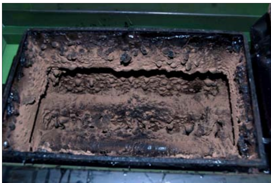
3 Zabrudzenie wymiennika kotła – palenie mokrym drewnem, za mały przekrój komina
