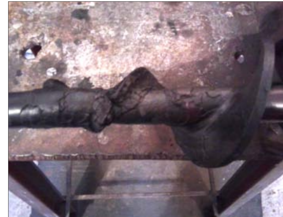
2 Uszkodzenie ślimaka w konsekwencji palenia mokrym opałem
