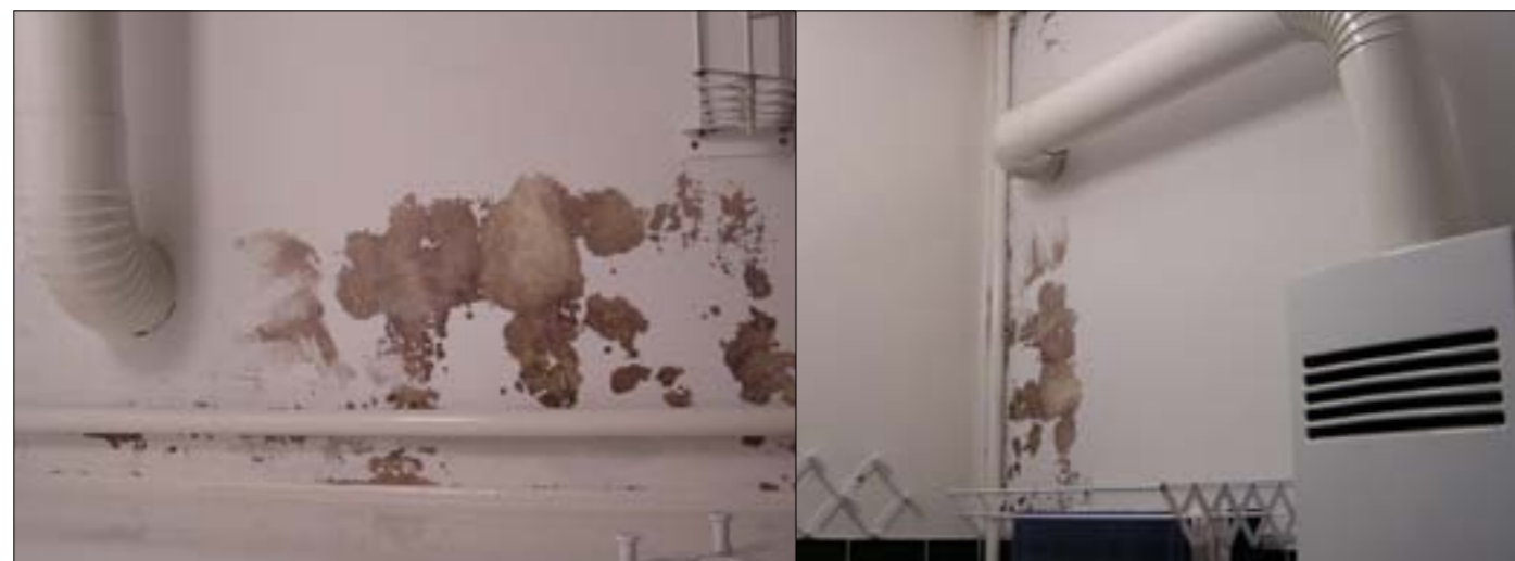
Brak wkładu ze stali kwasoodpornej dla przepływowego podgrzewacza gazowego i ...skutek widoczny
