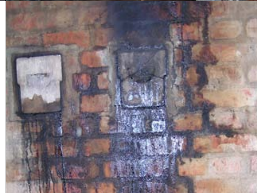
Sadza mazista - wykwyty na ścianie
