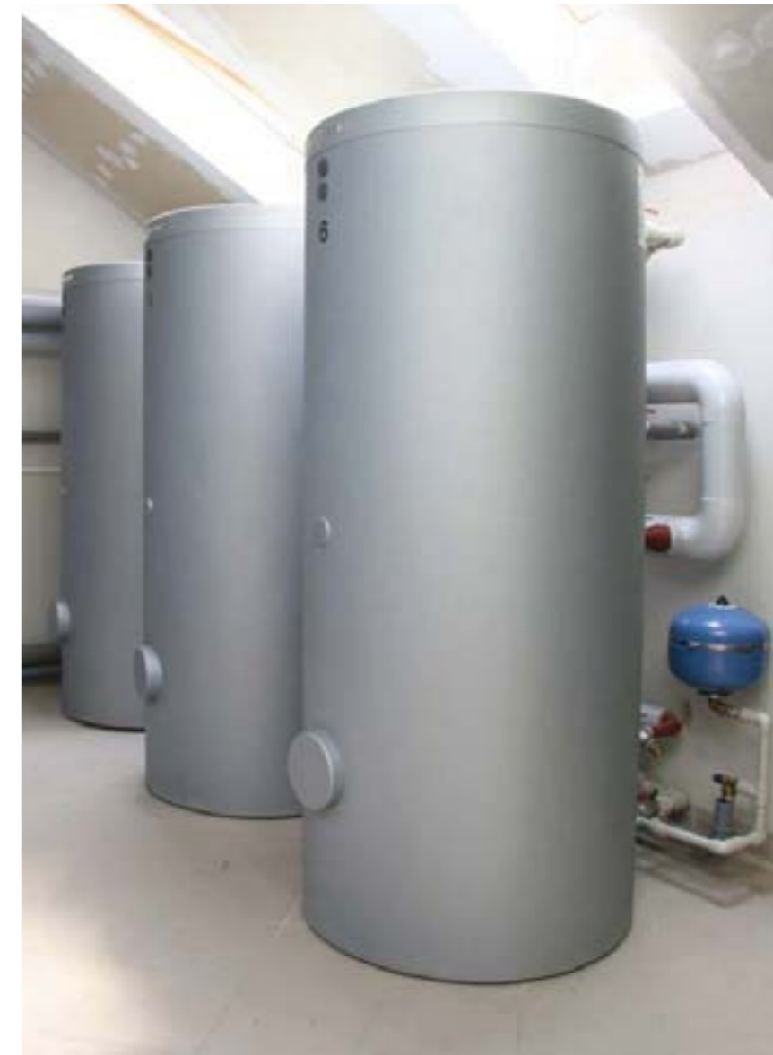
System grzewczy zamontowany na strychu pozwala na maksymalne wykorzystanie powierzchni
