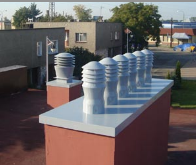
Przykład wywiewników grawitacyjnych Zefir na domu jednorodzinnym
