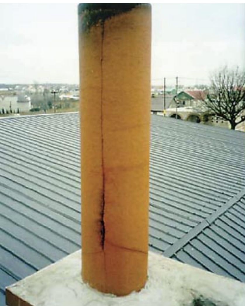
Pęknięta rura kamionkowa
