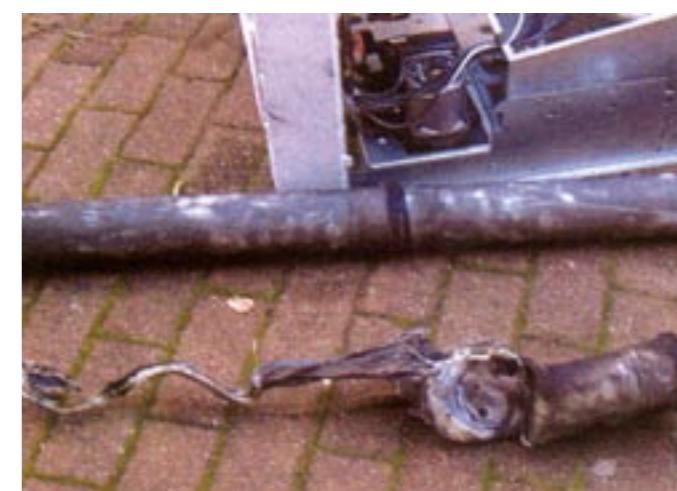
Spalone resztki termy i komina z PCV
