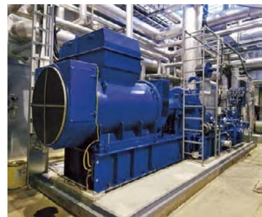
Generator w elektrowni na biomasę
