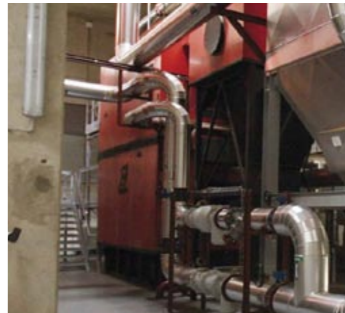
Kocioł na biomase. Zapewnia prawie 70% zapotrzebowania na energię potrzebną do ogrzania zakładu Limoges CHRU
