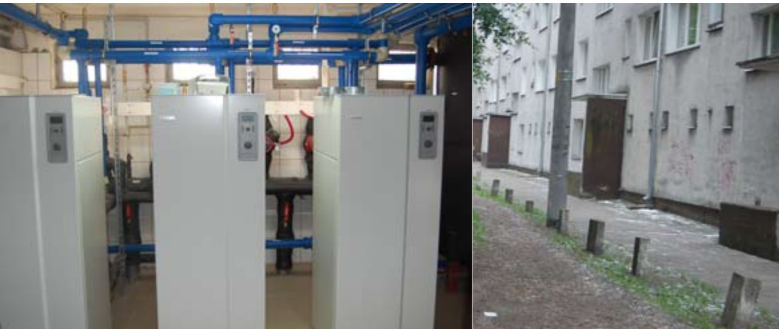
1 Kaskada pomp ciepła NIBE F 1330 o łącznej mocy 180 kW w budynku wielorodzinnym w Łebie
